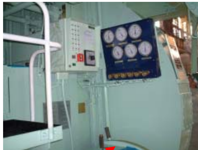
機側操縦台 (RTA機関)
