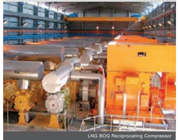
LNG BOG Reciprocating Compressor
