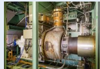
IHI製2MW級ガスタービン
