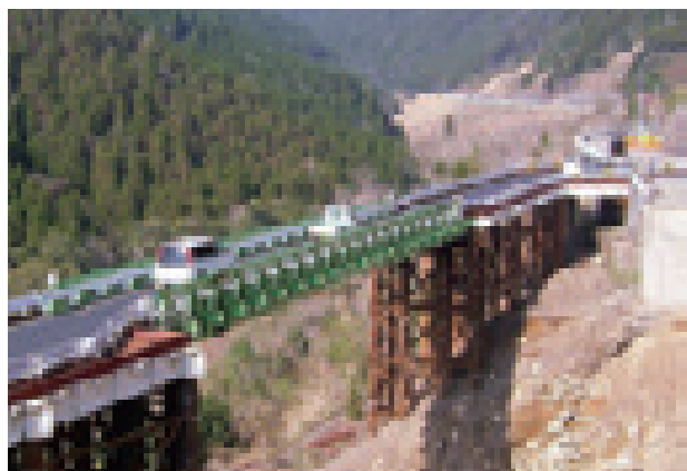
日南災害復旧仮橋(宮崎県) 構造形式:鋼下路式トラス 橋長:40.0m 竣工年:2008年
