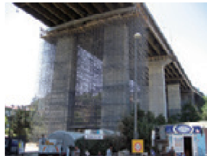
オルタキョイ高架橋耐震補強(トルコ) 構造形式:コンクリート門型ラーメン橋脚 橋脚高:16.7~39.6m 竣工年:2009年
