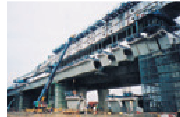
川越高架橋(三重県) 構造形式:PC(5+3+8+9+4)径間連続箱桁橋 橋長:1298.0m 竣工年:2002年
