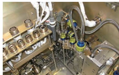
CCE内部(循環排気方式)
