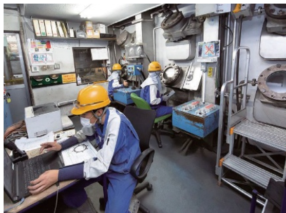
コントロール室
