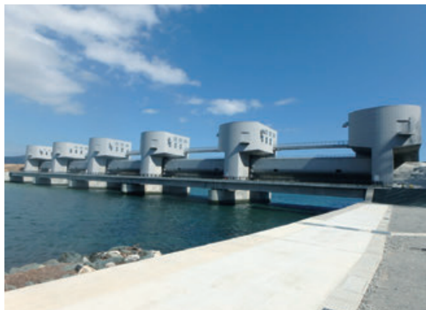
河川用ゲート(気仙川水門)
