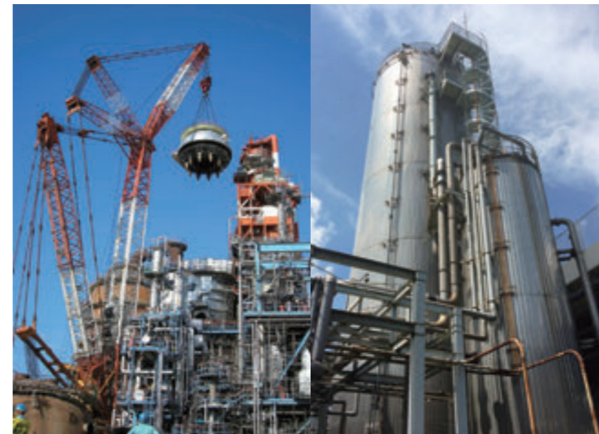
圧力容器 / 排水処理設備
