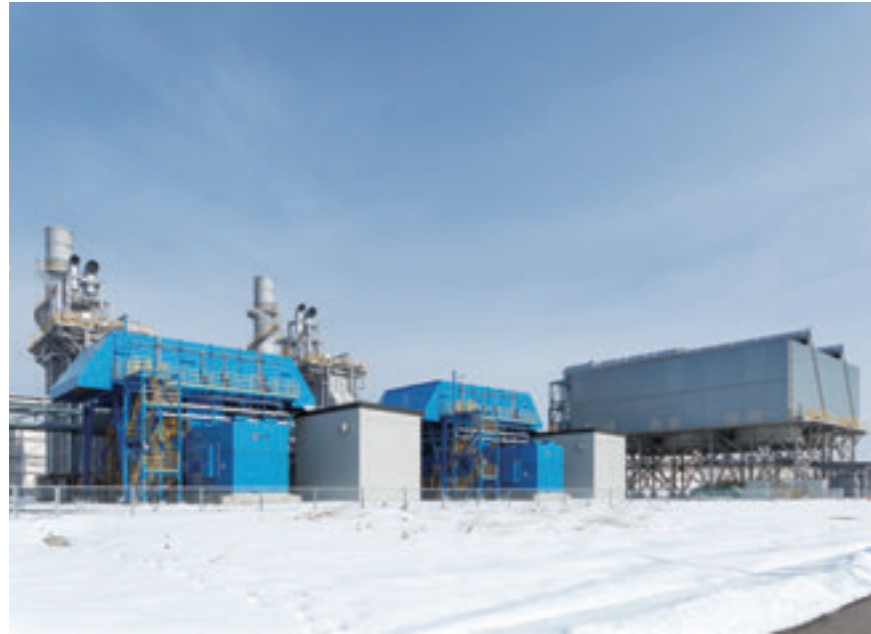
LM6000ガスタービン複合発電設備
