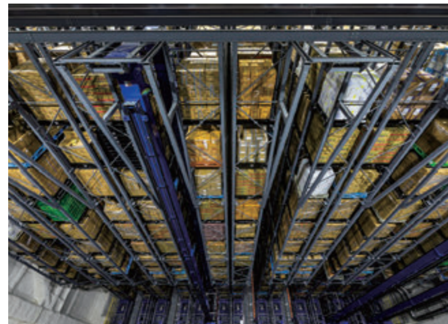
冷凍自動倉庫
