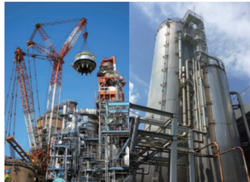
圧力容器 / 排水処理設備
