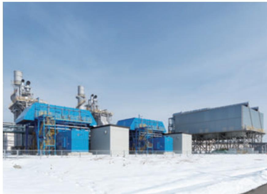
LM6000ガスタービン複合発電設備
