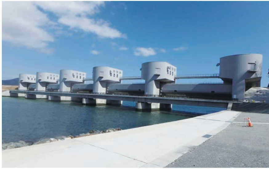
河道用闸门(气仙川水闸)
