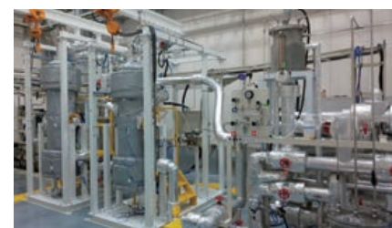
甲烷化示范试验设备
