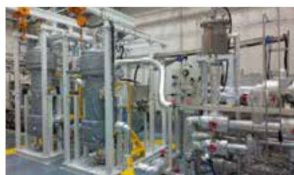
メタネーション実証試験装置
