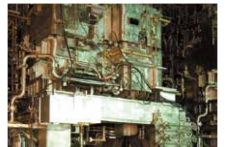
高レベル廃液ガラス固化設備
