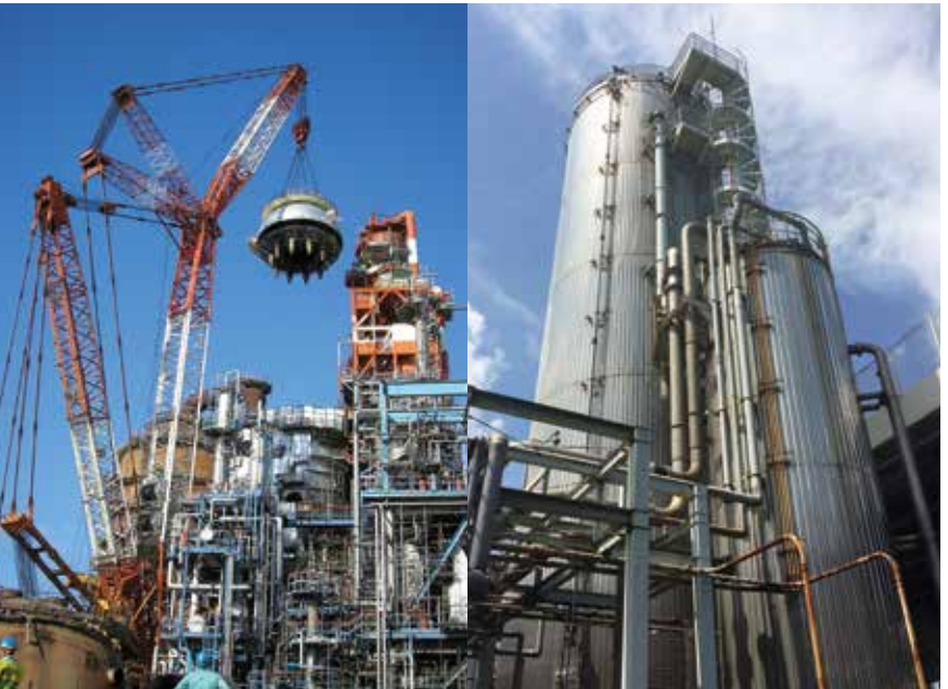
圧力容器 / 排水処理設備
