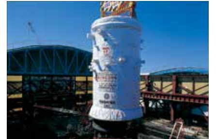
原子炉圧力容器
