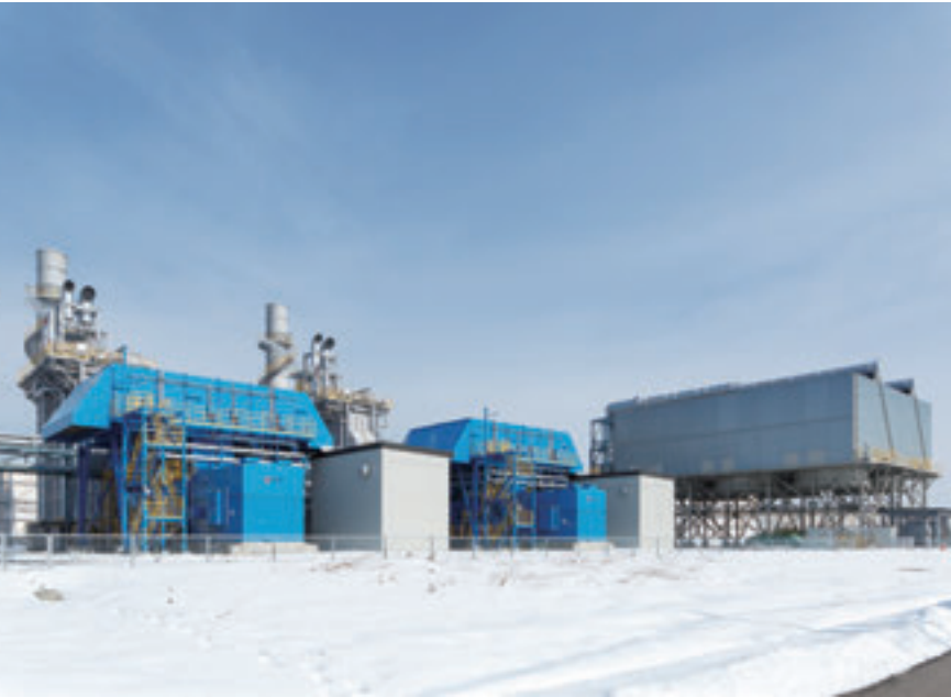
LM6000ガスタービン複合発電設備
