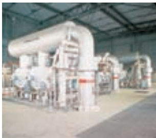
LNG reciprocating compressors
