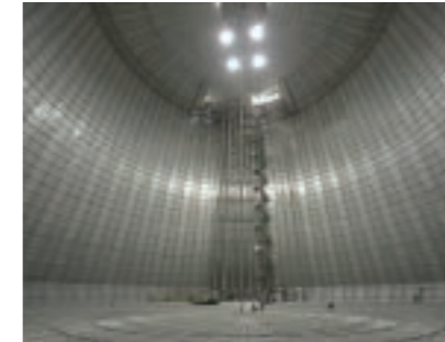
世界最大容量LNG 地下储气罐（膜结构） 照片提供：东京瓦斯株式会社
