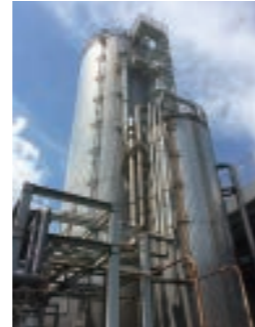
污水处理设施
