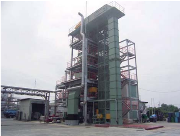
第3図 ドラム缶破碎システムの全景
