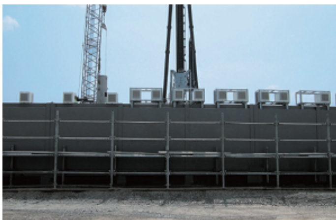
簡易防音壁と障壁騒音低減システム消音用スピーカ
