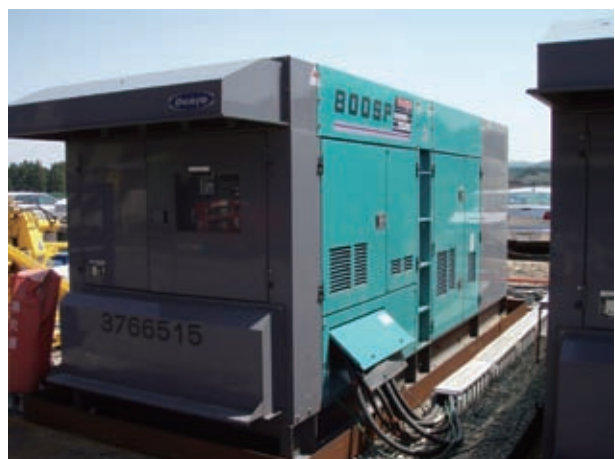
建設現場の代表的騒音発生源(ディーゼル発電機)
