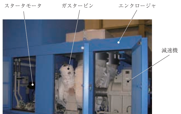
第5図 ポンプ駆動装置 外観 Fig. 5 External appearance of the pump drive unit
