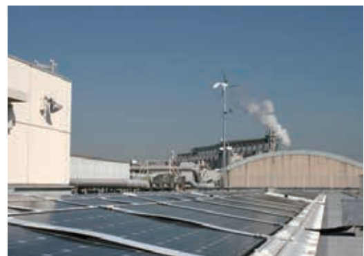
第4図 IHI 横浜事業所 太陽光発電システム Fig. 4 IHI Corporation Yokohama office photovoltaic generation system
