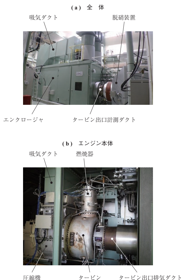
第 6 図 ガスタービン設備 Fig. 6 Apparatus of gas-turbine
