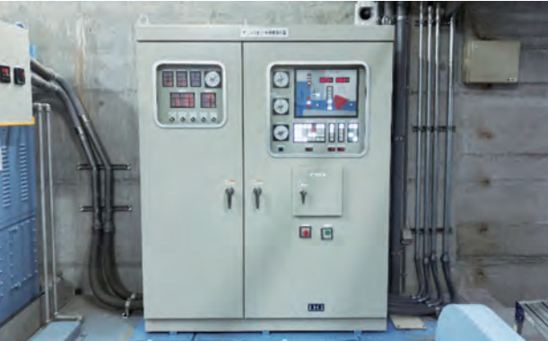
八田原ダムオリフィスゲート機側操作盤
