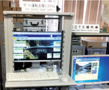
天ヶ瀬ダムゲート運転支援システム
