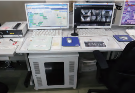
山国川樋門樋管遠隔監視制御設備
