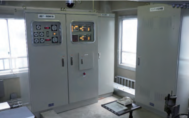
六角川河口堰調節ゲート機側操作盤
