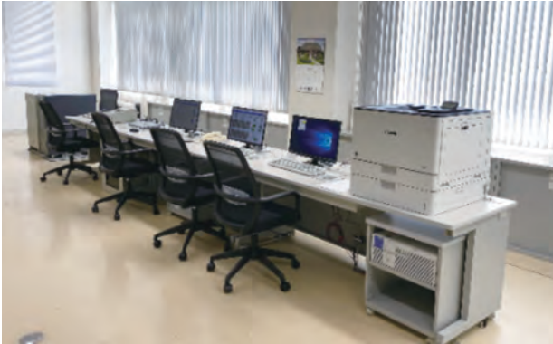
山王海ダム管理用制御処理設備 (放流操作装置)
