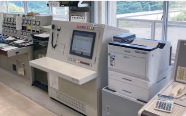
近畿農政局 ダム放流警報設備 (操作装置)
