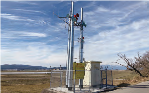
近畿農政局 ダム放流警報設備 (警報局)
