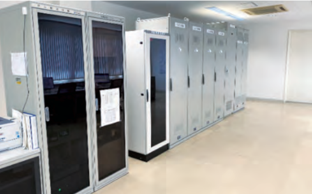
山王海ダム管理用制御処理設備 (入出力処理装置)
