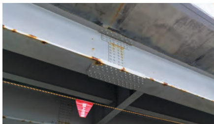
写真-2 添接部やコバ部での鋼材腐食事例
