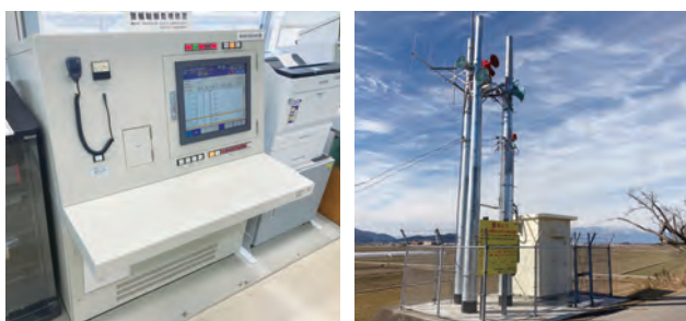
写真-5 警報制御監視設備 写真-6 放流警報設備(子局)
