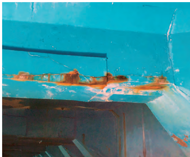
写真-6 今回発見された梁の損傷(今回写真)
