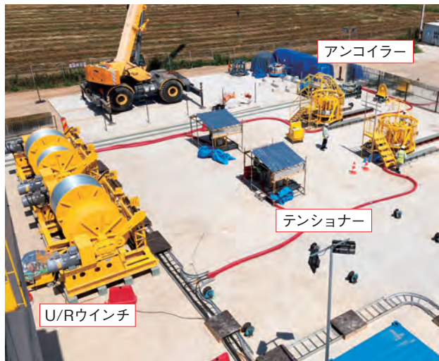
写真-10 リーリング設備
