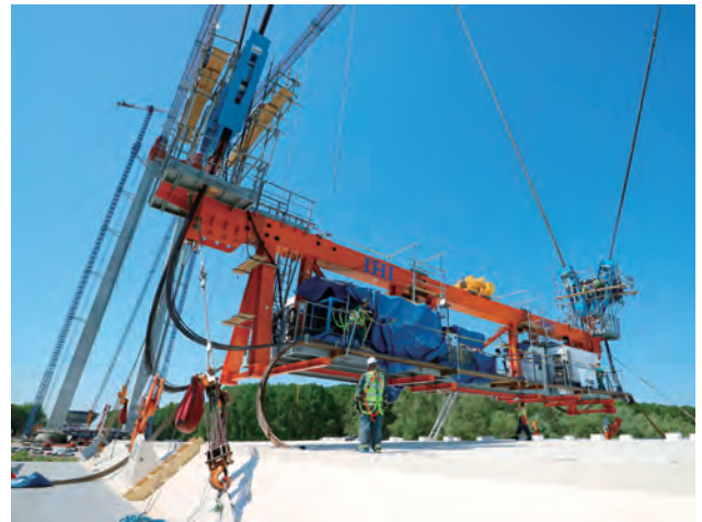
写真-24 荷揚げ設備 詳細
