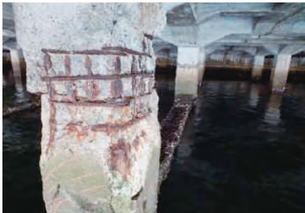
写真-1 栈橋床版下部の損傷事例
