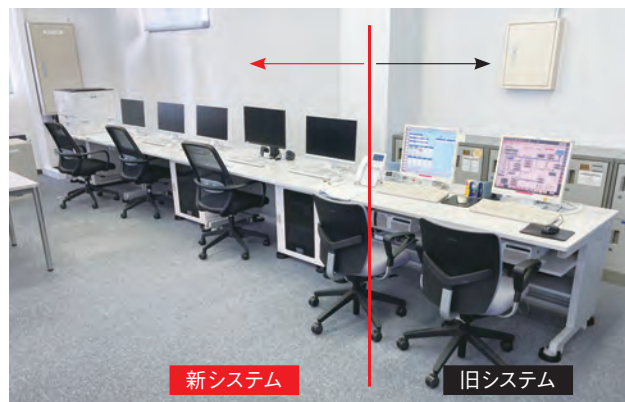
写真-13 新・旧水管理システム併用
