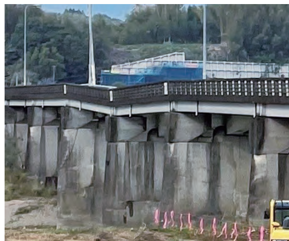
写真-2 球磨大橋被災状況
