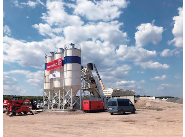
写真-15 JVコンクリートプラント
