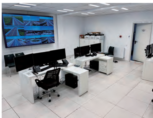
写真-20 コントロールルーム
