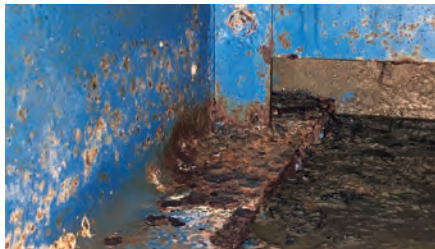
写真-1 桁端部での鋼材腐食事例
