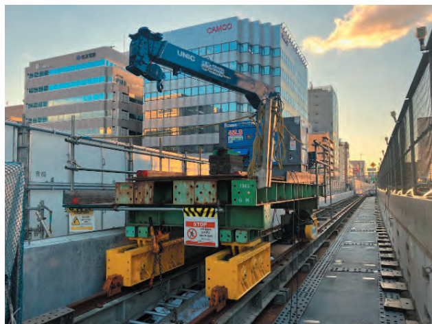
写真-12 橋上クレーン台車
