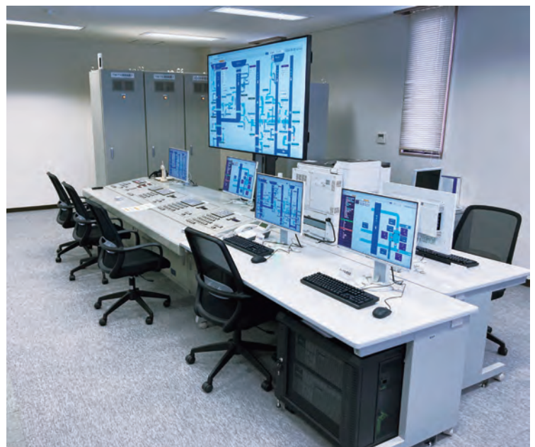
⑬ 会津北部農業水利事業水管理施設
