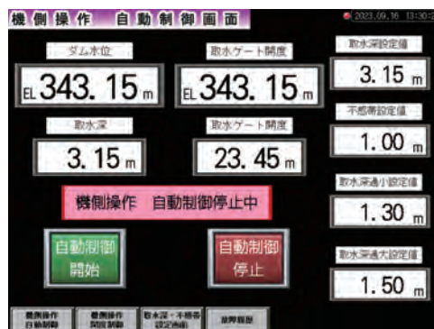
図-6 取水設備自動制御盤タッチパネル画面
