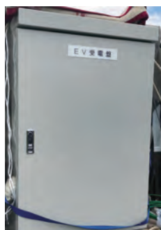
写真-5 EV受電盤
