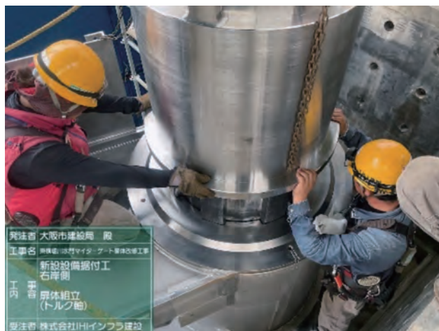
写真-14 右岸側 扉体トルク軸挿入
