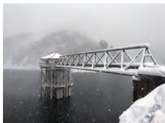
写真-11 積雪状況
