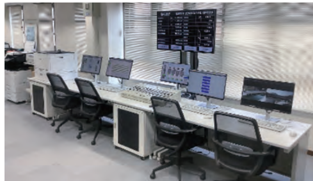
写真-2 十六橋水門管理所システム(完成)
