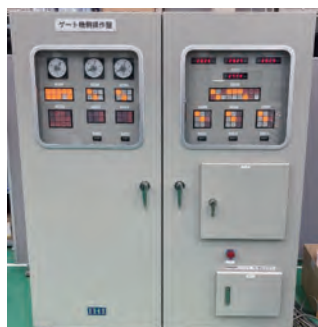
写真-2 機側操作盤
