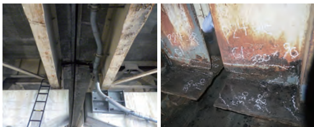
写真-3 主桁端部の腐食状況
