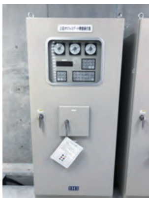
写真-3 機側操作盤
