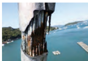
写真-2 腐食状況 (ケーブル0215)
