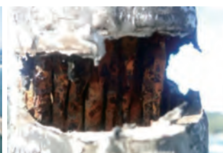
写真-3 腐食状況 (ケーブル0217)
