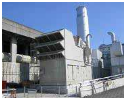
デュアルフューエルガスタービン発電装置 型 式: CNTM-30C 発電出力: 3200kW×3基 (非常用含) 燃 料: 消化ガス (メタンガス) / 灯油
