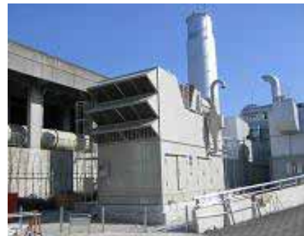
デュアルフューエルガスタービン発電装置 型 式:CNM-30C 発電出力:3200kW×3基(非常用含) 燃 料:消化ガス(メタンガス)/灯油
