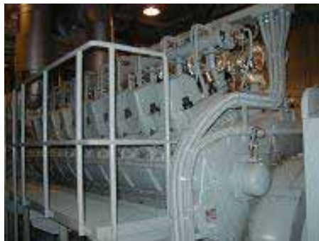
高効率ガスエンジン発電装置 型 式:18V22AG 発電出力:3200kW×1基 燃 料:消化ガス(メタンガス)
