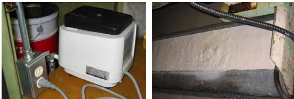
写真 左：送気用ポンプ、右：切削油タンク
