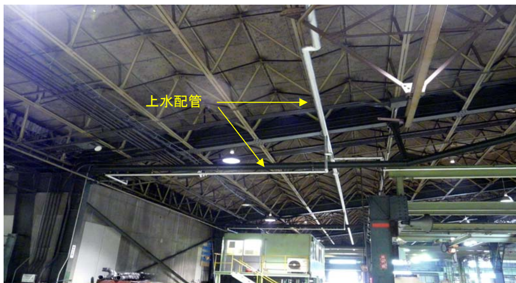
見える化した上水配管
