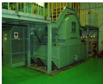
30 年間使用した発電装置 撤去前
