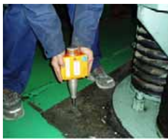
シュミットハンマーにて基礎表面 硬度を測定し、コンクリート圧縮強 度を推定
