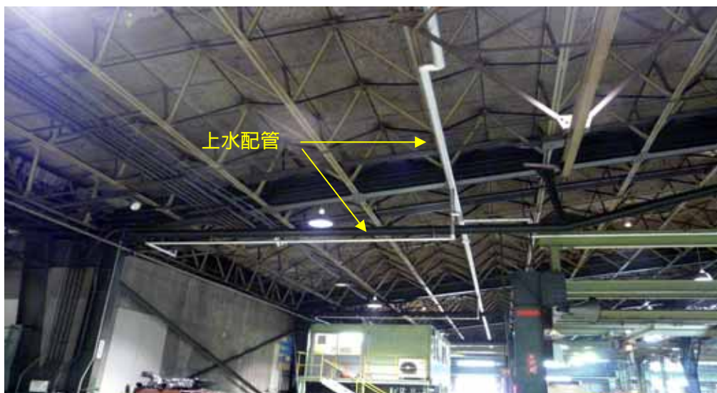
見える化した上水配管
