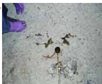
補強筋を挿入した箇所に、エポキシ 注入口より注入(近傍の亀裂箇所よ りエポキシがにじみ出る)
