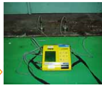
超音波デジタル式コンクリート 試験器を用いてコンクリート表 面に発生している亀裂の深さ を測定
