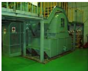
30年間使用した発電装置 撤去前
