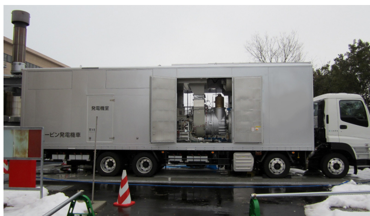
移動電源車 (ガスタービン発電装置)
