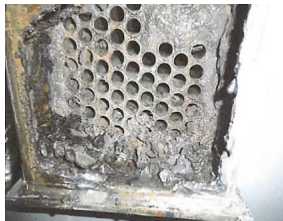
No.6 作業中（背面） 水室ケース溶断開放後 （腐食堆積物多数有）
