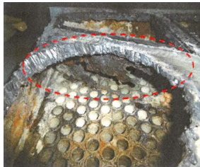
No.7 1号機 作業中（背面） 水室ケース溶断開放後 （仕切り板 腐食穴あき）
