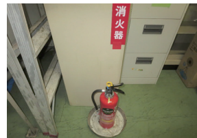
②消火器の設置
