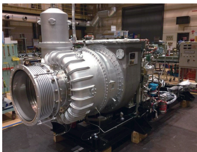
海外向けガスタービン非常用発電装置 27 台出荷完了
