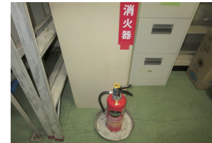
②消火器の設置
