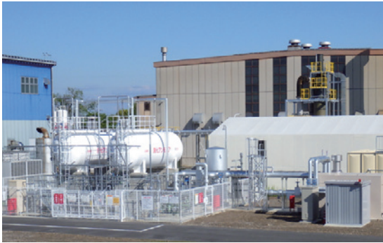
アンモニア燃料供給設備(太田工場)
