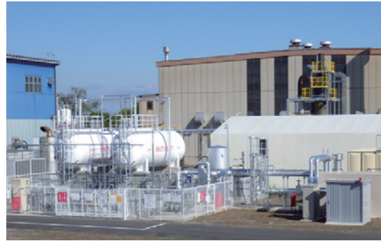
アンモニア燃料供給設備(太田工場)
