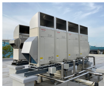
二階屋上 室外機
