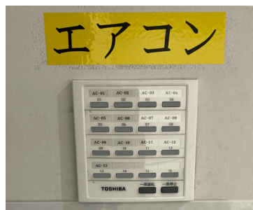
二階事務所 一斉操作盤
