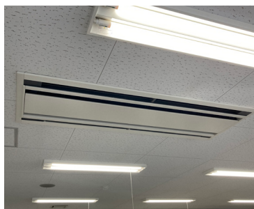
二階事務所 室内機
