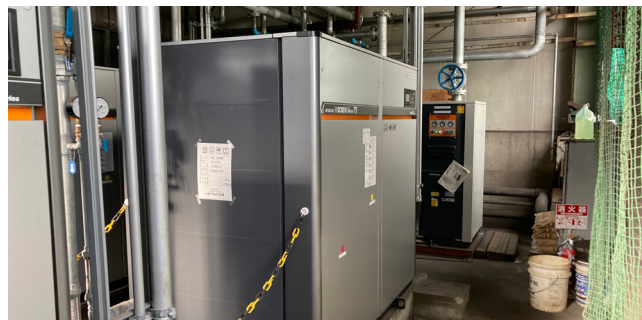
コンプレッサー
