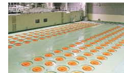
出典：日本原燃ホームページ ガラス固化体貯蔵設備
