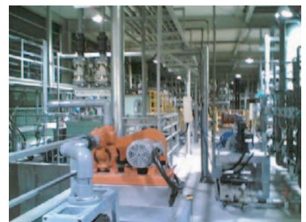
相馬第二工場の排水処理システム
