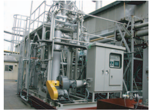
VOC回収ユニット (右室内がIM270ガスタービン発電設備)
