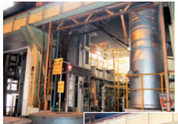
鑄造部12トン熱処理炉
