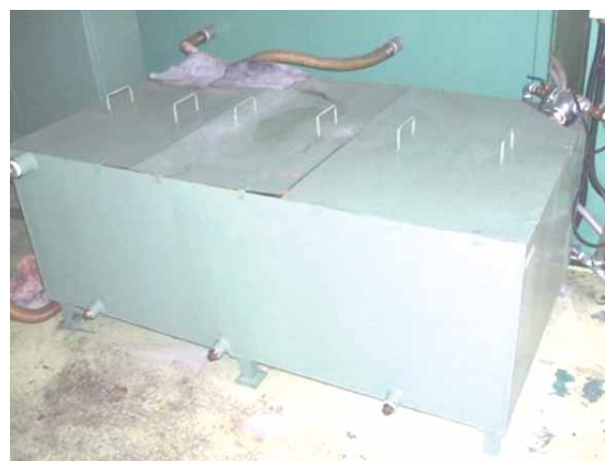
バレル研磨排水循環設備
