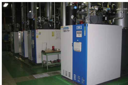
燃料転換されたガス炊きボイラー（4台）
