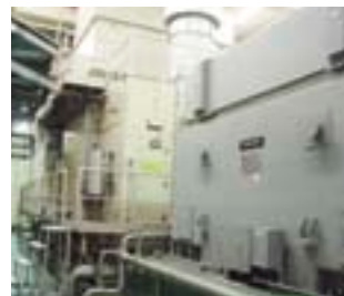
瑞穂工場 ガスタービン発電設備
