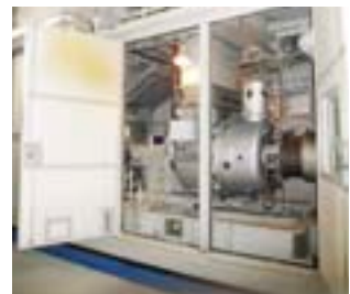
豊洲本社 自家発電設備
