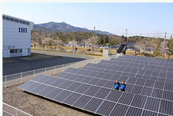
太陽光発電設備の外観
