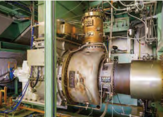
液体アンモニアと天然ガスを混焼した2,000kW級ガスタービン (当社 横浜事業所内)
