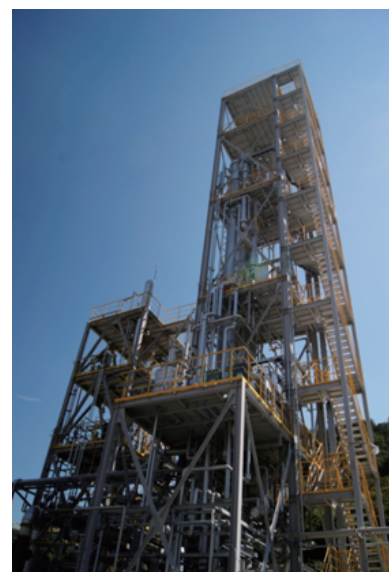
20 t-CO 2 /d パイロットプラント
