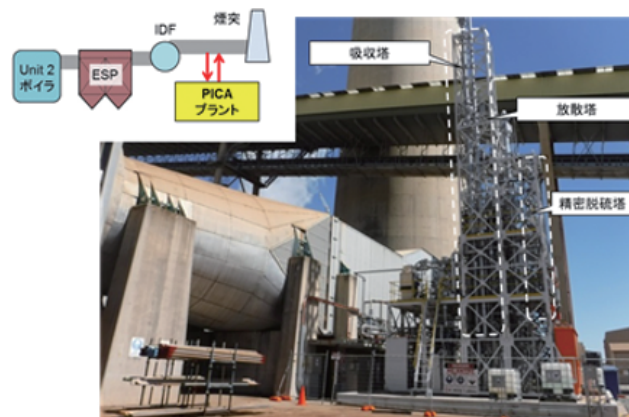
オーストラリア Loy Yang A 発電所実証試験装置
