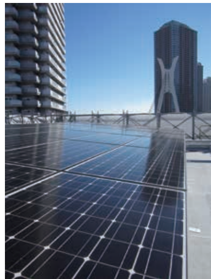
マンションへの設置例
