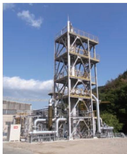
化学吸収法パイロットプラント (20 ton-CO 2 /day)
