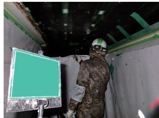
第 30 図 炭素繊維補強の状況 Fig. 30 Work status for carbon fiber reinforcement
