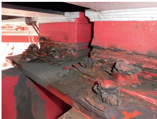
第 4 図 床トラス上弦材の腐食の状況 Fig. 4 Corrosion condition at upper chord of floor truss
