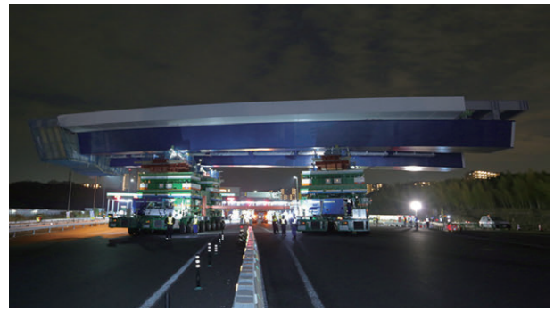
第5図 多軸自走台車による一括架設 Fig. 5 Erection by self-propelled modular transporter
