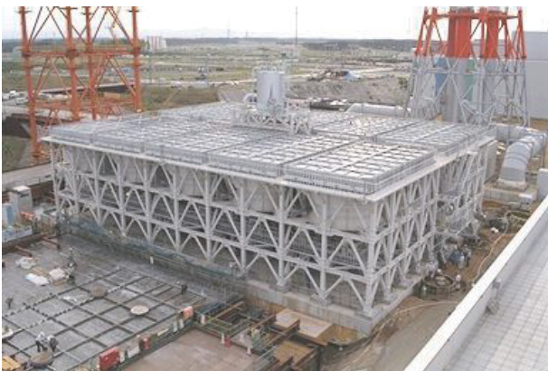
第 2 図 原子力施設向け AFC Fig. 2 Air-cooled heat exchanger for a nuclear facility
