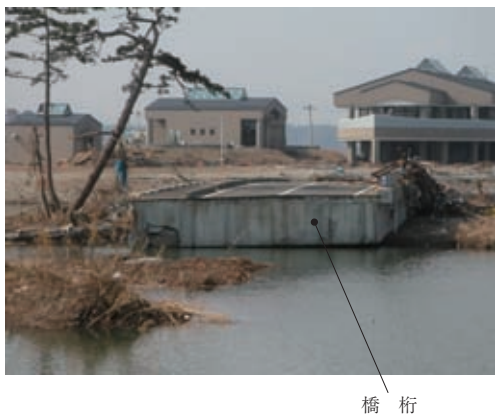
第6図 上流へ流された橋桁
