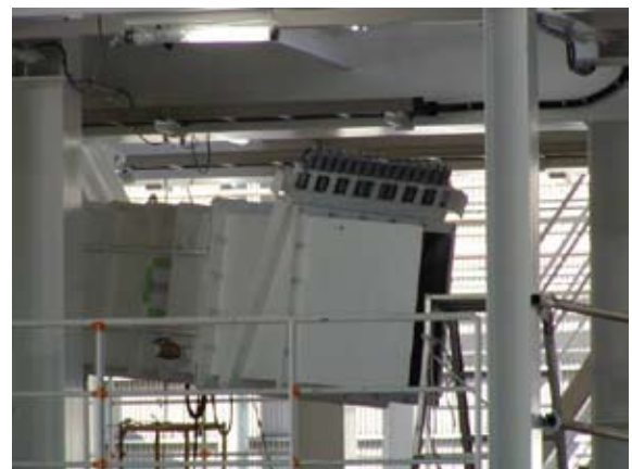
第 12 図 大和川線シールド スクリューコンベヤ土砂ホッパ Fig. 12 Dirt hopper attached to screw conveyor of Yamatogawa line shield
